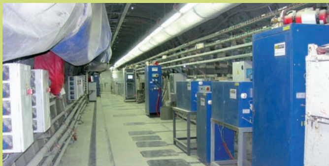
Galerie d'expérimentations géochimiques avec les armoires de contrôle des équipements
